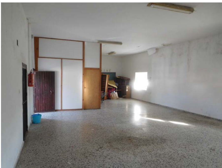
Imagen interior actual de entreplanta con importantes humedades.
